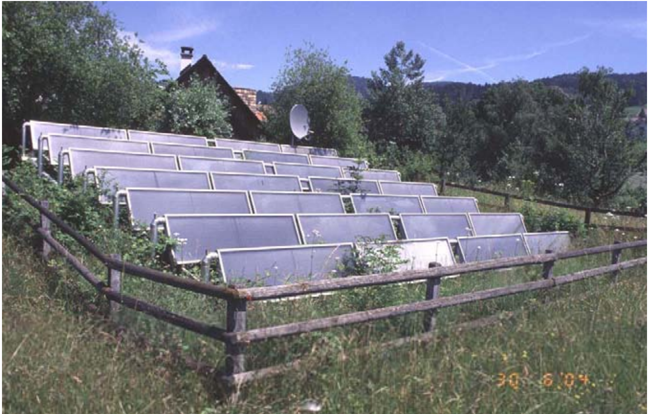
Solarkollektor-Anlage mit Gebäude im Hintergrund 2004 Spezifischer Kollektorsertrag immer noch O.K. mit rund 400 kWh/m 2 a
